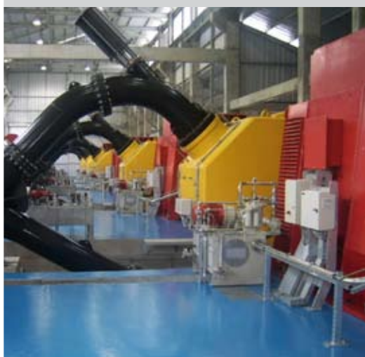
Ecuador DIG171 (8500kVA)
